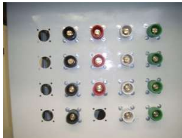
Distribución general de tablero con conectores rápidos tipo CamLock
