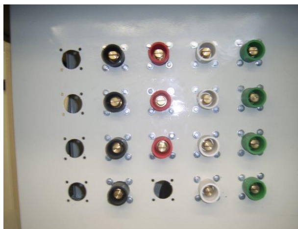
Distribución general de tablero con conectores rápidos tipo CamLock
