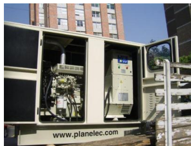
Equipo SuperCompacto Abierto
