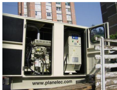
Equipo SuperCompacto Abierto
